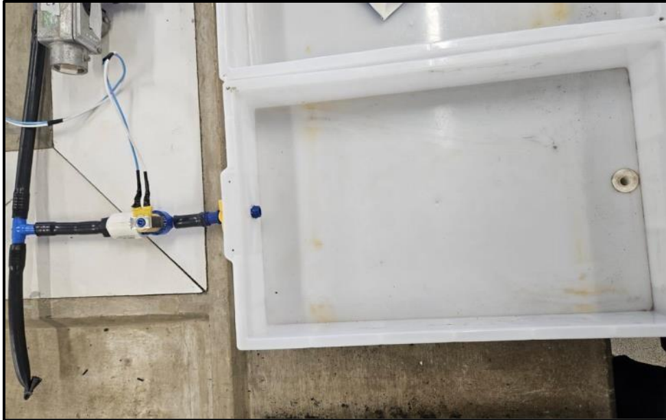
Figura 8: Visão de cima de uma válvula solenóide conectada na parte de irrigação da bandeja.
