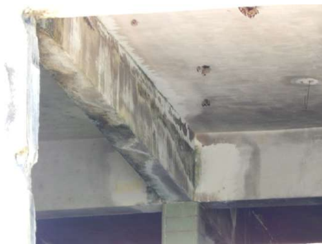
Infiltração interna. Fonte: Arquivo pessoal. Dez de 2019.
