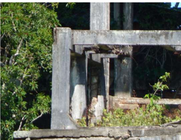
Detalhe da ferragem exposta. Dez. 2019. Fonte: Arquivo pessoal.
