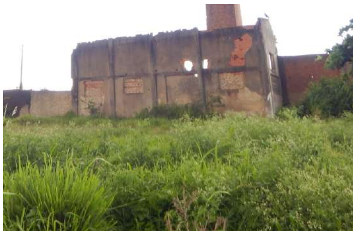
Estrutura arruinada que se une ao muro Dez. 2019. Fonte: Arquivo Pessoal
