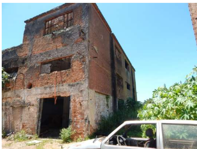
Ausência de reboco em grande parte do prédio. Fonte: Arquivo pessoal. Dez de 2019.
