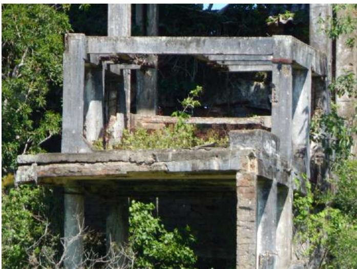
Detalhe de rachadura no pórtico. Dez. 2019. Fonte: Arquivo pessoal.
