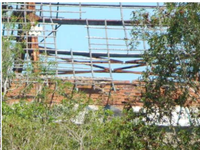
Estrutura da cobertura oxidada. Dez. 2019 Fonte: Arquivo Pessoal
