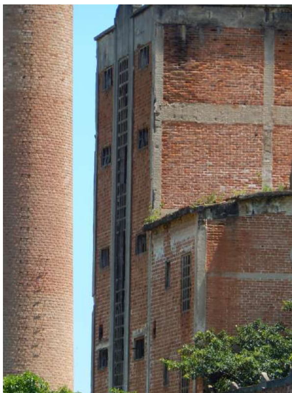
Abertura alongada no prédio de 5 pavimentos. Dez. 2019. Fonte: Arquivo Pessoal
