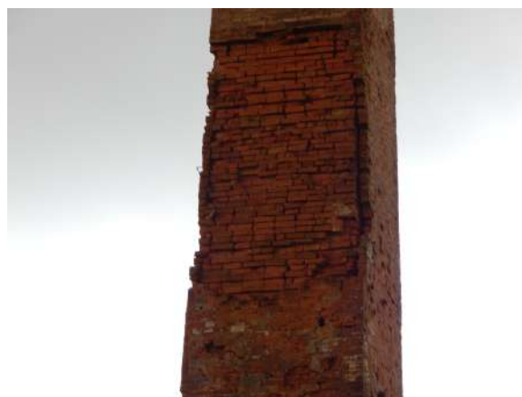
Desprendimento de parte dos tijolos da chaminé. Dez. 2019. Fonte: Arquivo Pessoal
