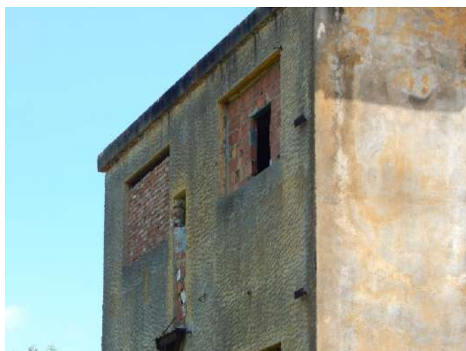
Vedação de lajota em algumas aberturas. Fonte: Arquivo pessoal. Dez de 2019.
