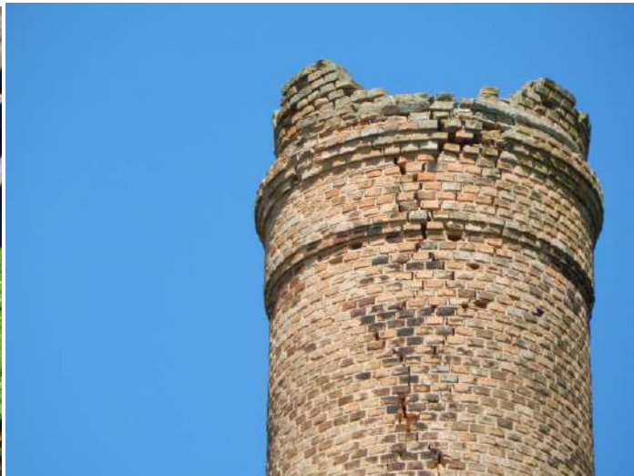
Chaminé com rachaduras. Dez. 2019. Fonte: Arquivo pessoal.
