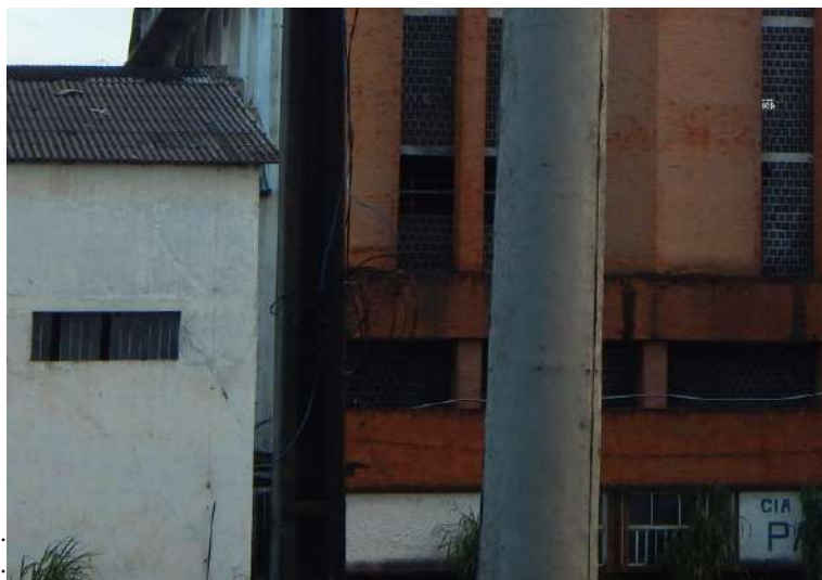
Vidros e cobogós quebrados. Dez. 2019. Fonte: Arquivo Pessoal.
