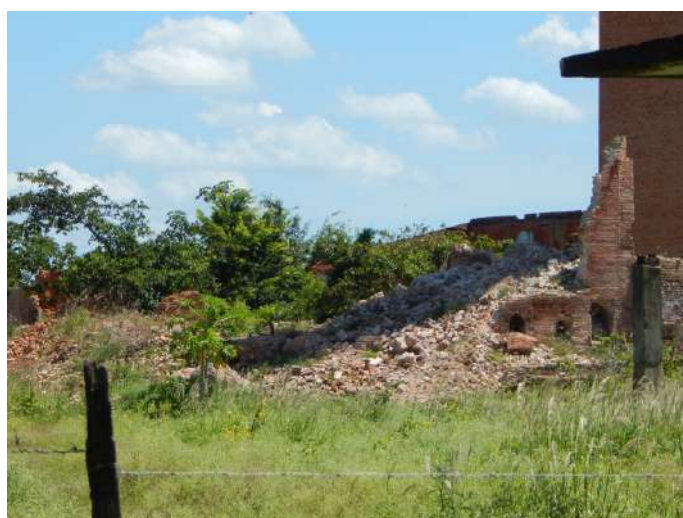
Arruinamento das estruturas da usina. Dez. 2019. Fonte: Arquivo Pessoal.
