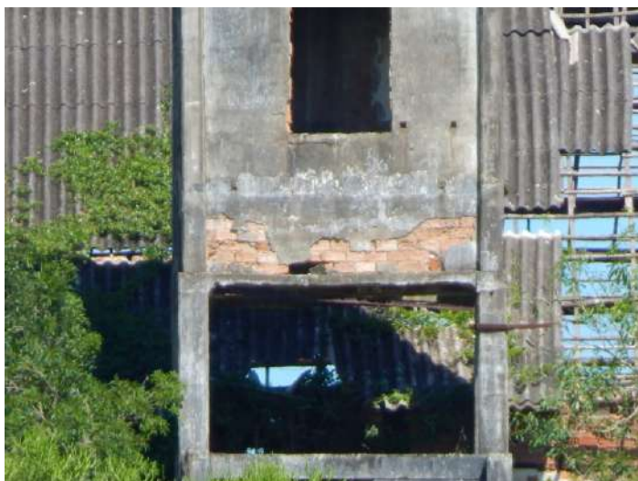
Parte da construção sem reboco. Dez. 2019. Fonte: Arquivo pessoal.
