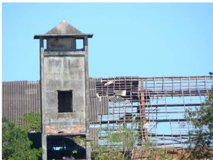
Galpão sem parte da cobertura. Dez. 2019. Fonte: Arquivo Pessoal
