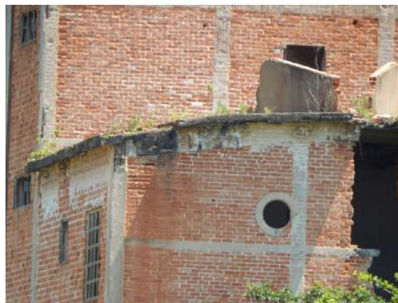
Ferragem da estrutura aparente e desprendimento de parte da parede em uma das edificações. Dez. 2019 Fonte: Arquivo Pessoal.
