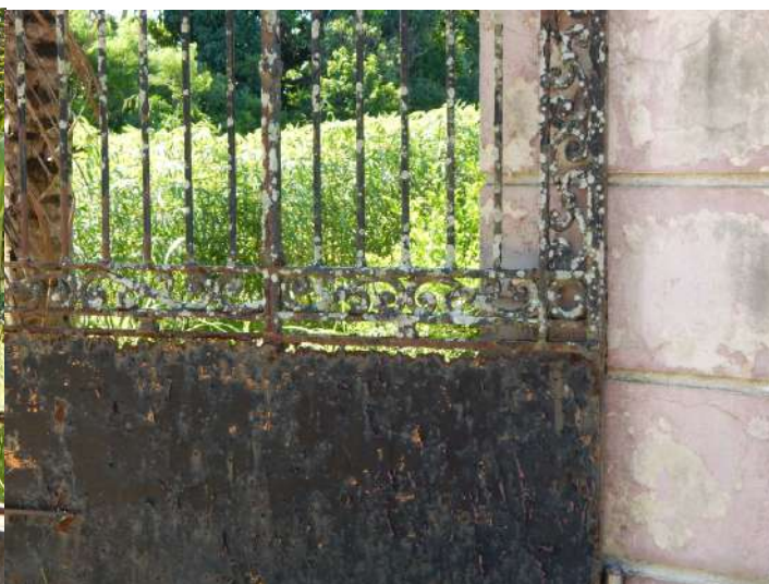
Gradil da suposta residência enferrujado. Fonte: Arquivo pessoal, 2019
