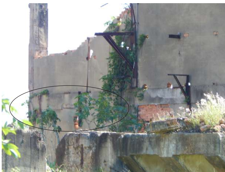
Parede galpão 1 com destaque para a ferragem exposta Fonte: Arquivo pessoal, 2019
