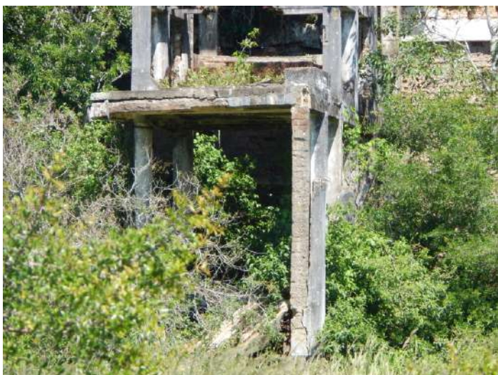
Pórticos comprometidos. Dez. 2019. Fonte: Arquivo pessoal.
