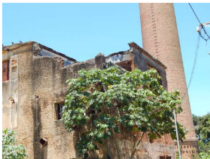
Lateral do prédio com parte da cobertura desmoronada. Fonte: Arquivo pessoal. Dez de 2019.
