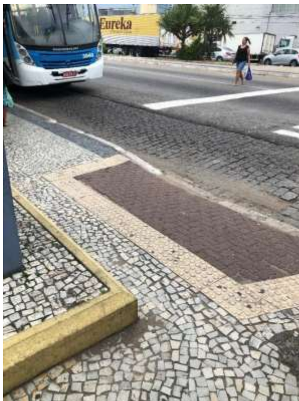
Figura 8: Rampa irregular no ponto de ônibus da Beira
