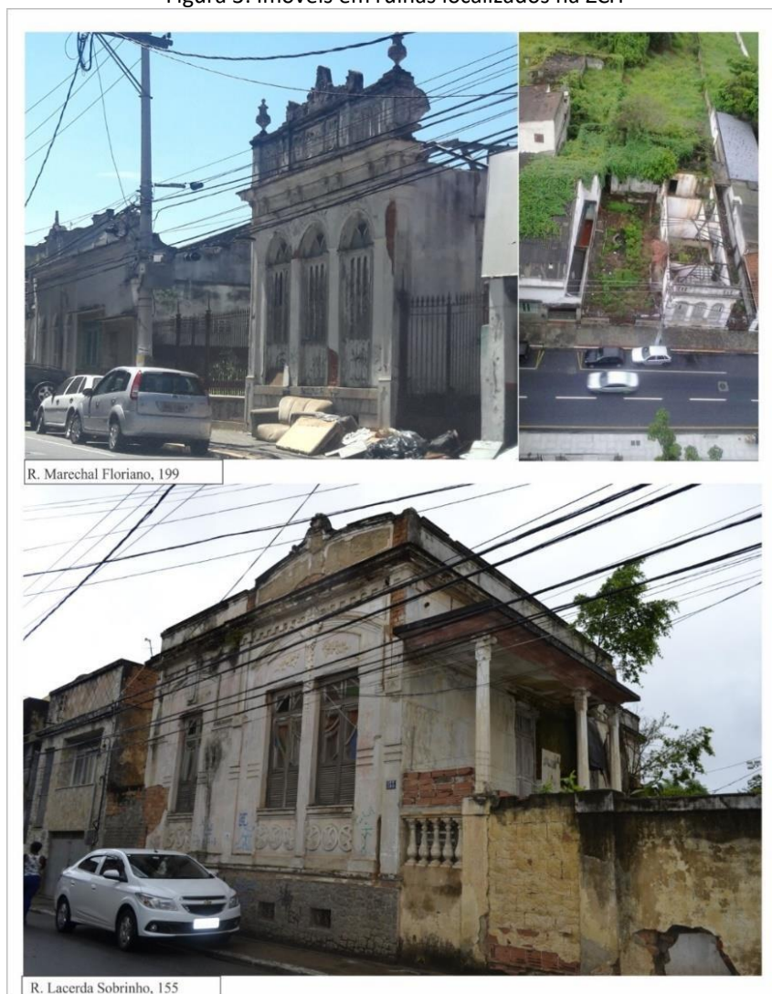
Figura 3: Imóveis em ruínas localizados na ZCH
